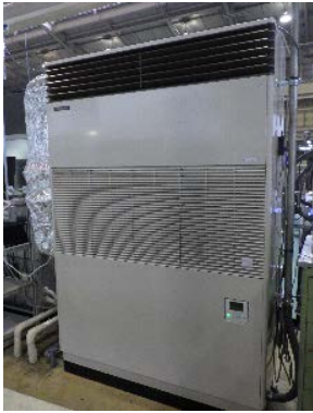
省エネ エアコンへの切替え (プラ金型工場)
