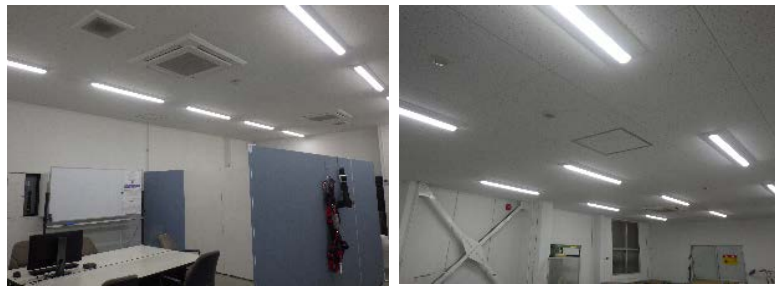
LED照明への切替え (プラ金型 打合せ室) (タイヤ金型 仕上げ室)
